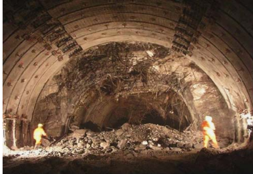
Squeezing à Faido (tunnel de base du Gothard)
