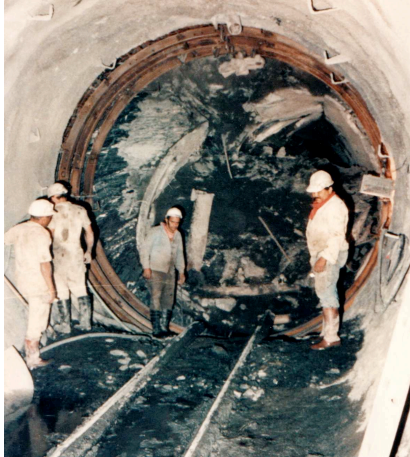
Squeezing au tunnel Yacambu-Quibor au Venezuela
